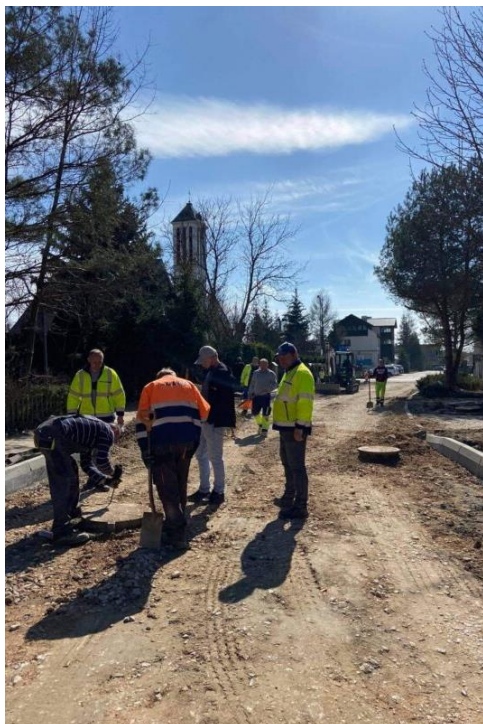
Kanalizacja deszczowa w Nieporęciu
