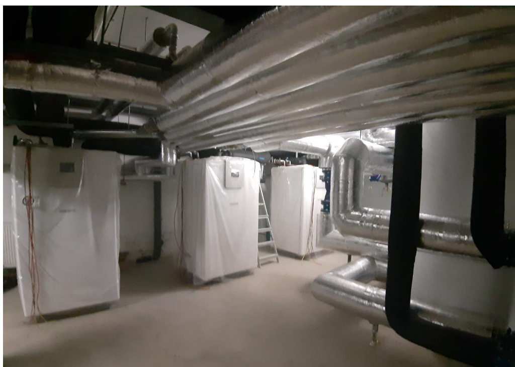
Termomodernizacja Szkoły Podstawowej w Stanisławowie Pierwszym – maszynownia pompy ciepła
