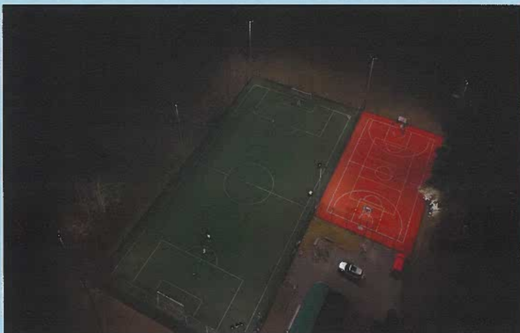
MODERNIZACJA OŚWIETLENIA ORLIKA W JÓZEFOWIE
